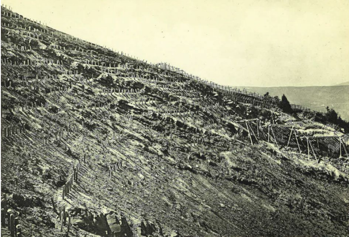
Abb. 16: Typische Verpfählungen gemäss dem Coaz'schen Lawinenschutzkonzept. Quelle: Coaz 1910: Abb. XXI. Hier im Bild ist die Verbauung „Höllbach“ im Kanton Freiburg um circa 1908 zu sehen. Unten rechts sind einige Schneeschutzbrücken, im hinteren Bereich ist die Umzäunung der Aufforstungsfläche erkennbar.
